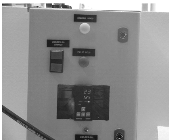
Figura 3 - Detalhe do painel de controle do protótipo de autoclave aquecida eletricamente.
